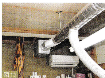
図12 各ベッドの排煙装置は天井に設置された換気扇につながっており、灸の煙はこの配管を通り屋外に放出される
